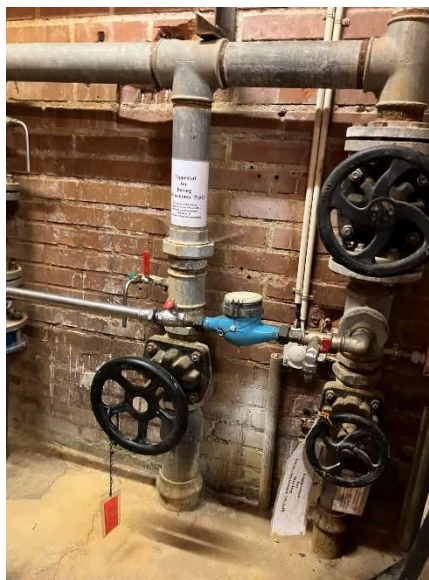
Prøvehaner råvand (DGU 79.820) og afværgéboring (DGU 79.541)
