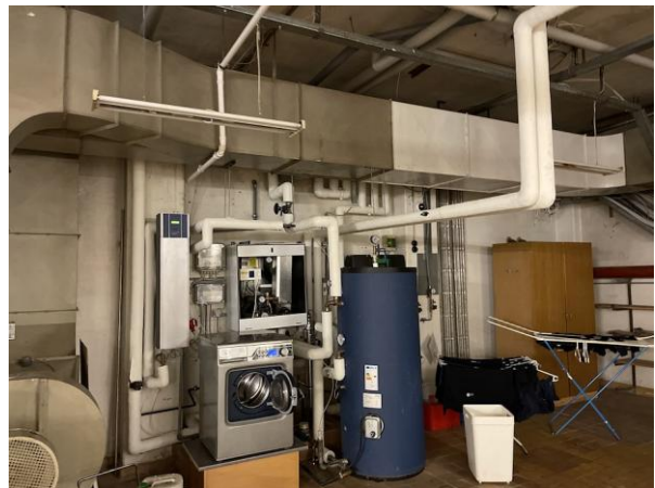
#18 Projekt 79 Legionellaanlæg. Anlæg er monteret på eksisterende ledninger.
