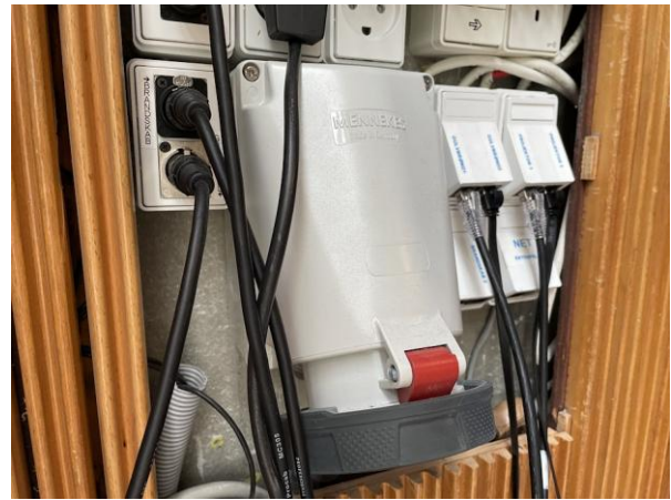
#10 Projekt 57. Stik er monteret på betonvæg.
