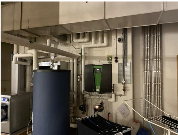
#17 Projekt 79 Legionellaanlæg. Anlæg er monteret på eksisterende ledninger.
